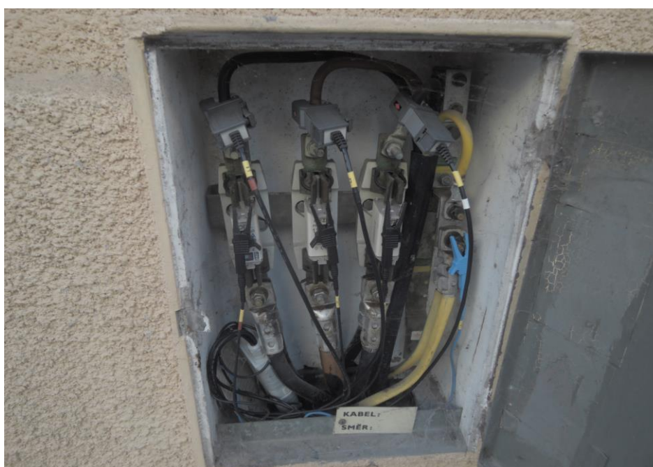
Obrázek 31: Měřící zařízení v činžovním domě ve Vršovicích.
